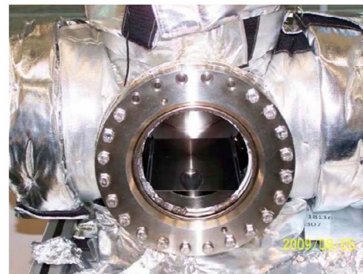
Foto: Gesprongen kijkvenster
