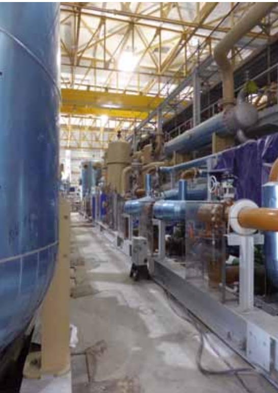
Blik op de cryoplant van ITER, 5.400 m 2 exclusief de opslagtanks voor helium en stikstof. De constructie is afgerond in 2017.
